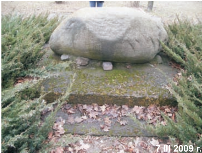
stan przed remontem
